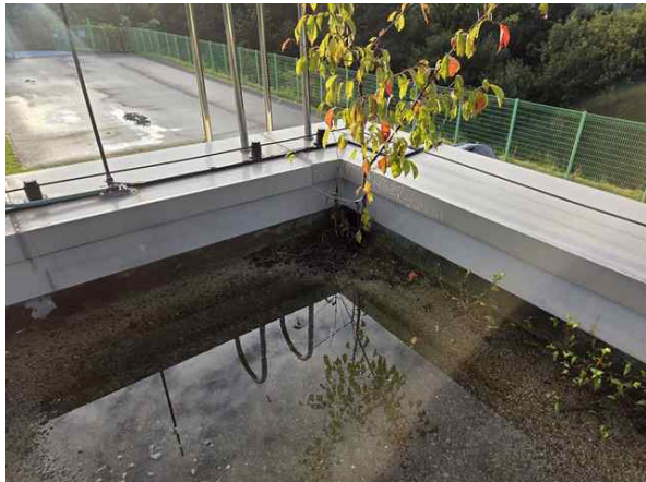
<검수실 옥상층 배수로 막힘>
