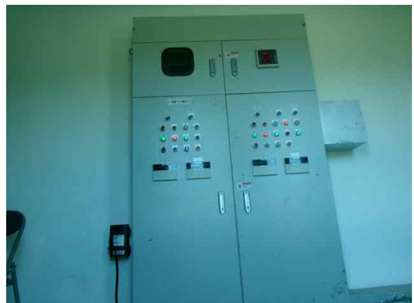
<전기설비 현장제어반 상태양호>
