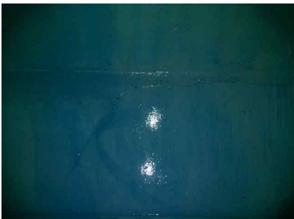
<1지 벽체 균열>
