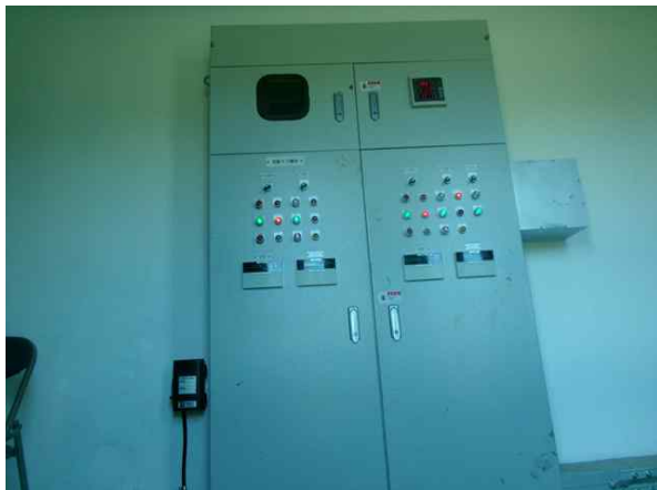
<전기실 내부 전경>
