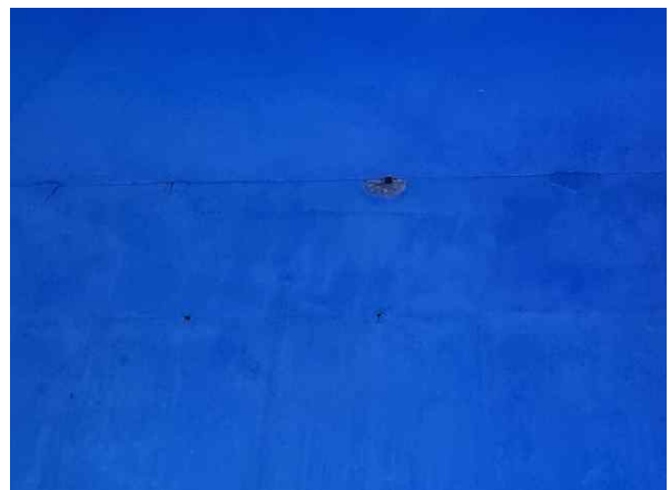
<2지 벽체 콘크리트 박락>
