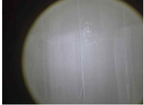
<유입밸브실 벽체 균열>
