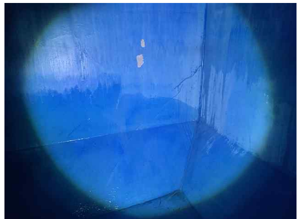
<2지 벽체 균열>
