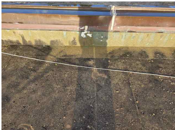
<검수실 옥상층 균열>
