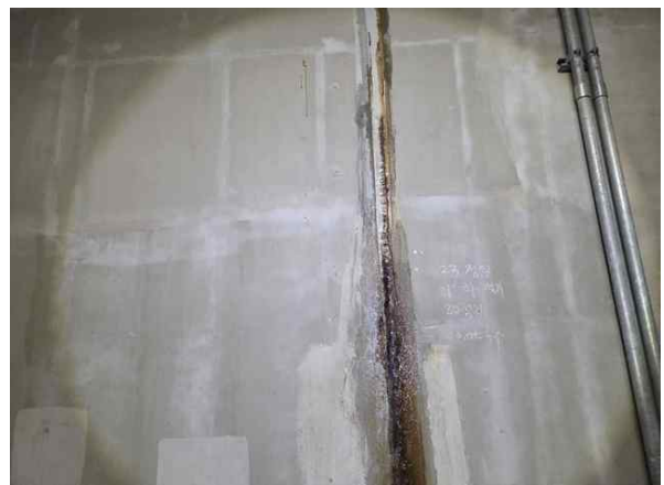
<유입밸브실 벽체 실란트 열화 및 누수>
