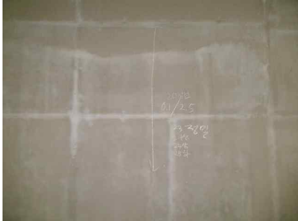
<유출밸브실 벽체 균열>
