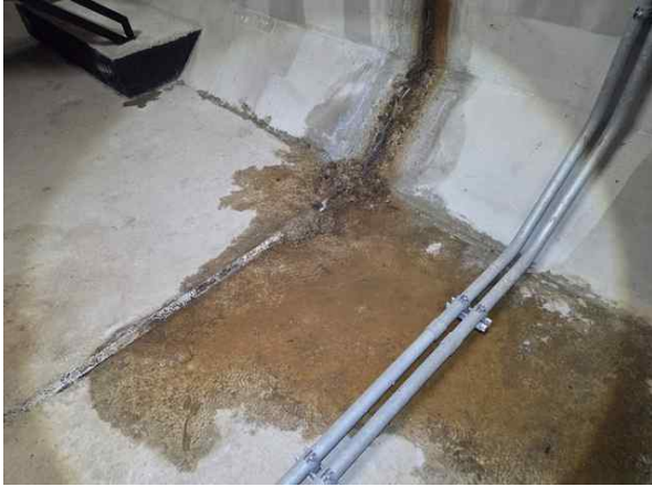
<유입밸브실 바닥슬래브 누수>
