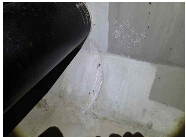
<유입밸브실 균열부 백태>
