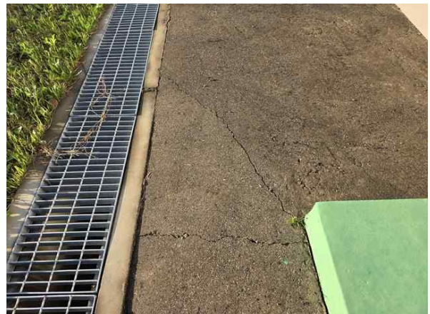
<검수실 외부바닥 균열>
