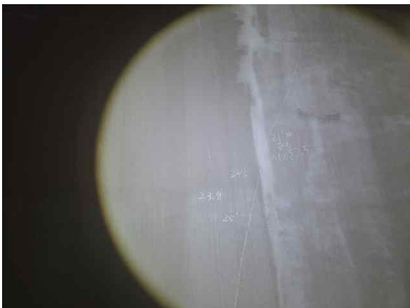
<유입밸브실 벽체 균열>
