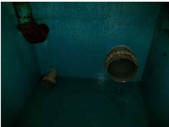
<기계설비 1지 배수지유출배관 상태양호>
