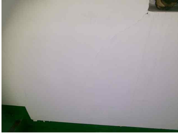
<검수실 벽체 균열>
