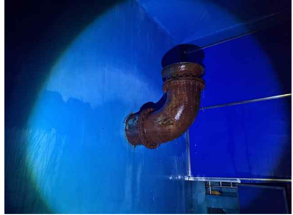
<기계설비 2지 배수지 배관 부식>
