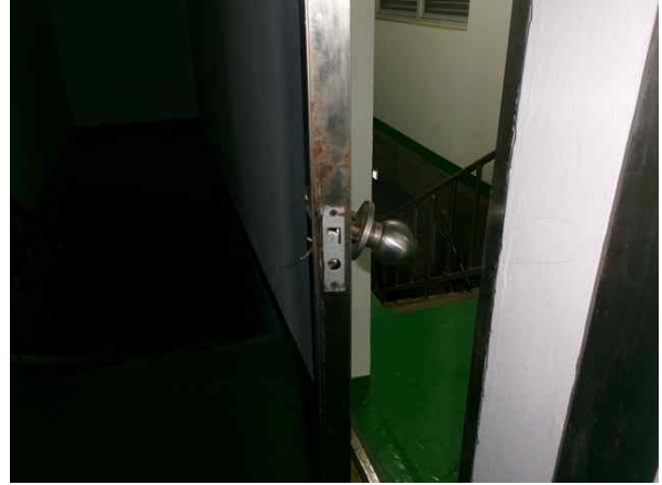
<검수실 내부도어 손잡이 파손>
