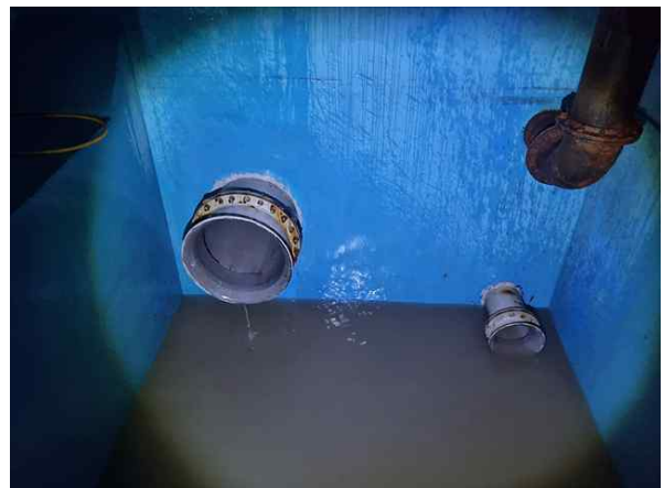
<기계설비 2지 배수지유출배관 상태양호>
