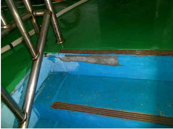
<1지 계단 파손>
