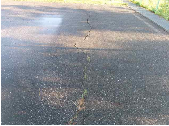
<포장부 아스콘 균열>
