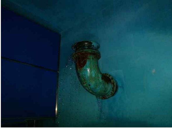
<기계설비 1지 배수지 배관 부식>
