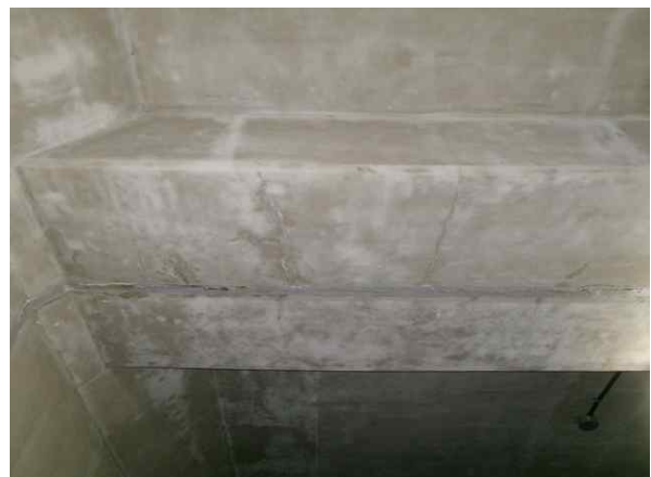
<유출밸브실상부슬래브 균열부 백태>
